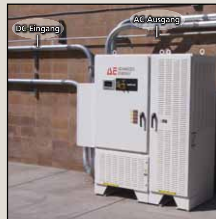
Der AE Solaron® 333 kW Wechselrichter im Einsatz bei Cline Cellars
